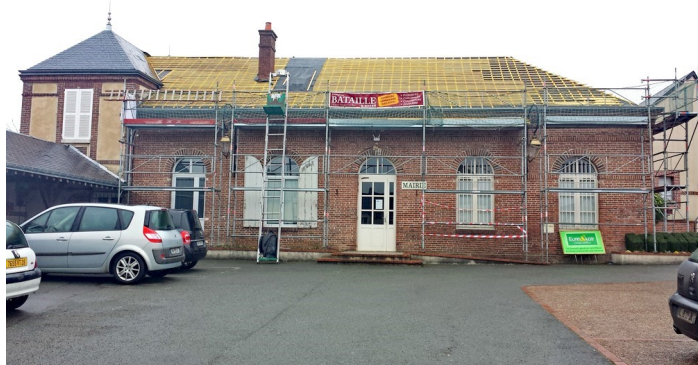
Réfection de la toiture de la Mairie qui était en très mauvais état.
